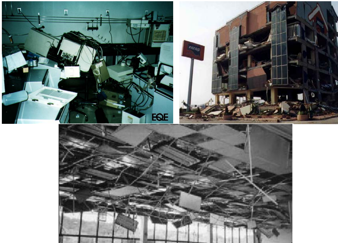
شکل ۳- در اثر زلزله تجهیزات داخل ساختمانها فرو می افتند و موجب آسیب‌های جانی و خسارات مالی می‌شوند.
